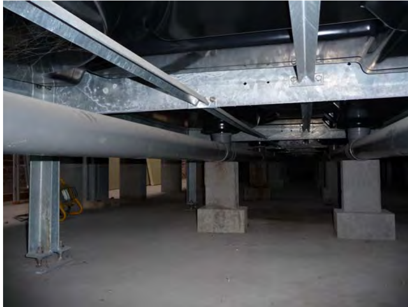
Figuur 53: rioleringsysteem gesteund op betonblokken.
