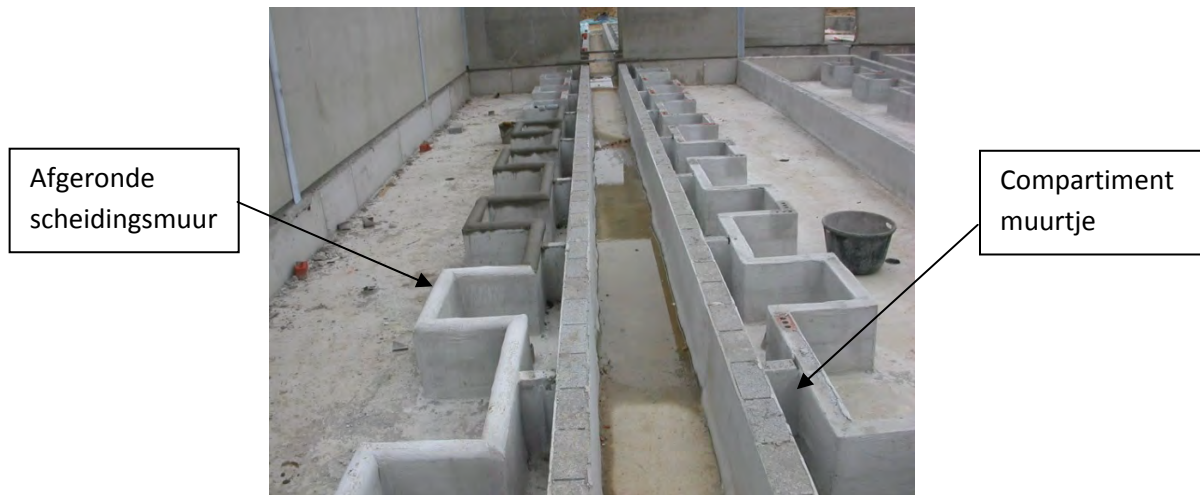
Figuur 30: Gecompartimenteerd mestkanaal en afgeronde scheidingsmuren.
