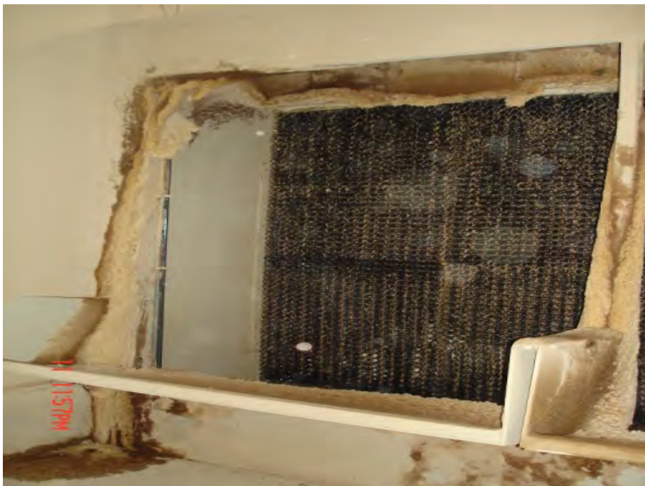
Figuur 13: Zoutvorming in een chemische luchtwasser.
