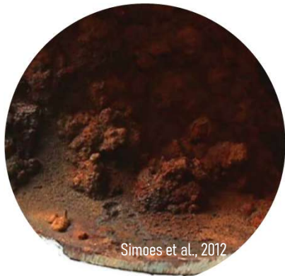
Binnenkant ijzeren leiding met biofilm en corrosie
