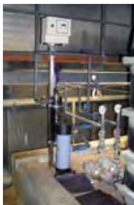
UV-installatie met zakkenfilter.
