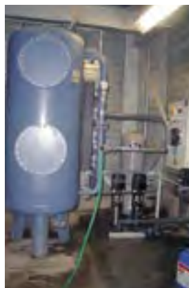
Automatische zandfilter met dosering.
